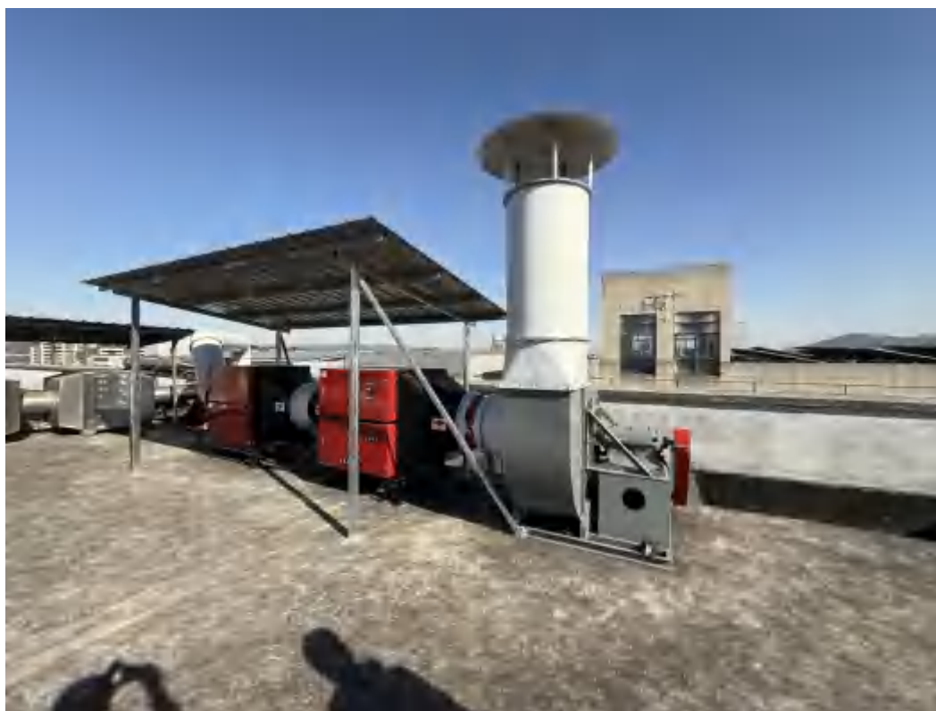
图 3-3 项目废气处理设施
